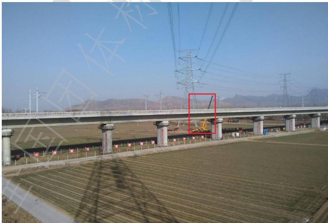
图 14 吊车_扬臂截断情况
